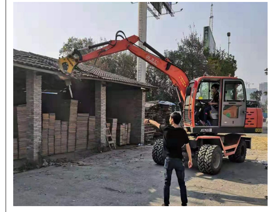
9月27日上午,武陵区南坪街道拆违办联合区拆违办、南坪派出所及多个城管中队,对芙蓉北路共计占地30余亩的七处堆场开展集中整治,共用车辆18台,出动工作人员143人,累计拆除存量违法建设850平方米,拆除私建围挡1000米。图为拆除现场。 陈宜鹤 摄
